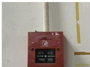
Fire alarm button.JPG
